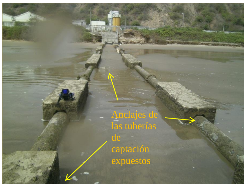
Fotografía 7: Tuberías de captación
