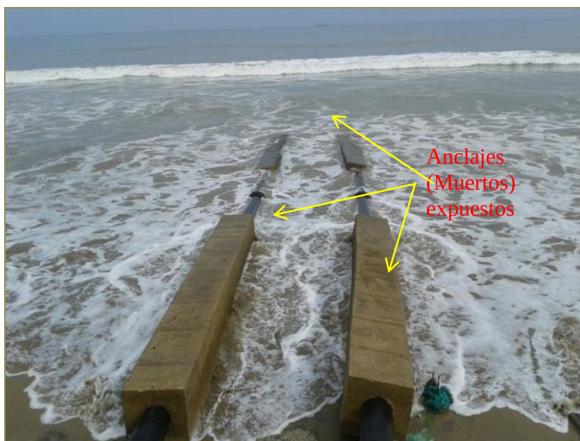
Fotografía 5.-Tuberías de captación
