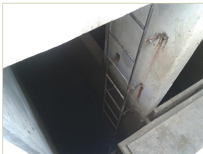
Fotografía 2: Pozo de bombeo (interior)
