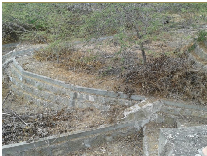
Fotografía 12: Canal de aguas lluvias existente
