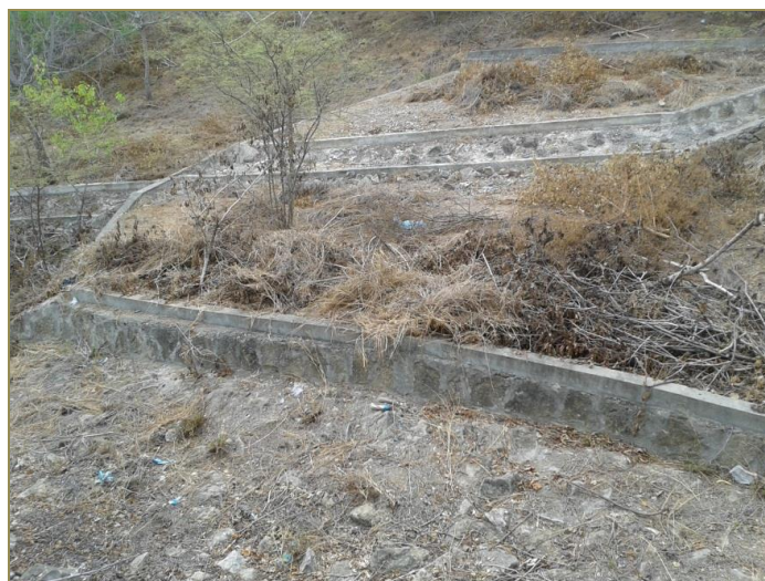
Fotografía 11: Canal de aguas lluvias existente
