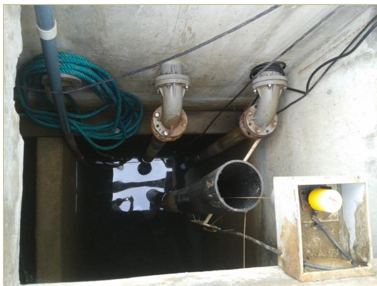
Fotografía 3: Pozo de bombeo (interior)
