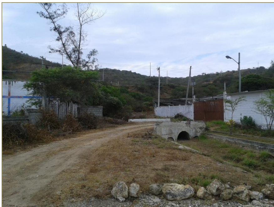
Fotografía 14: Canal de aguas lluvias existente
