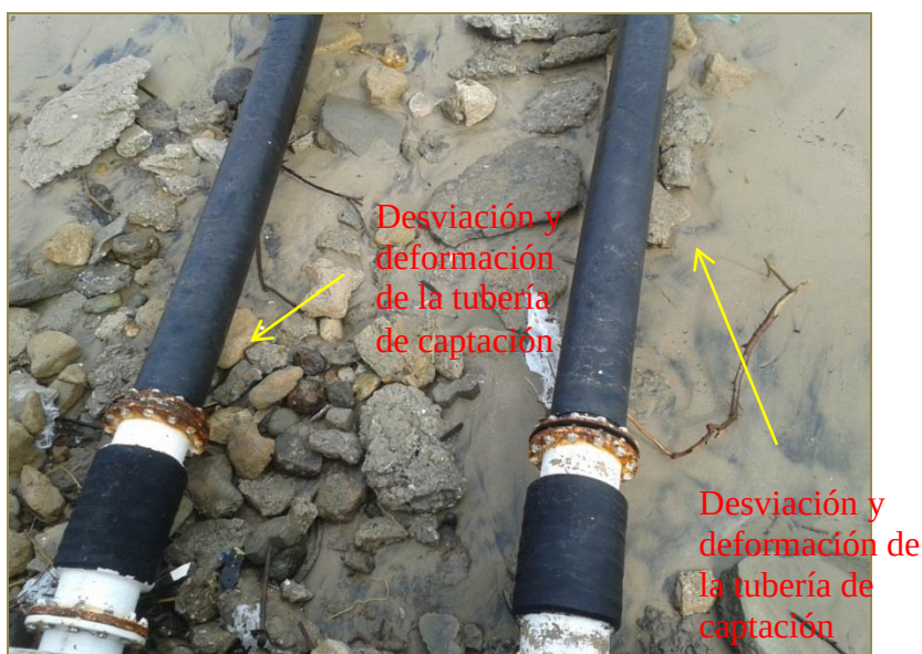
Fotografía 6.- Tuberías de captación
