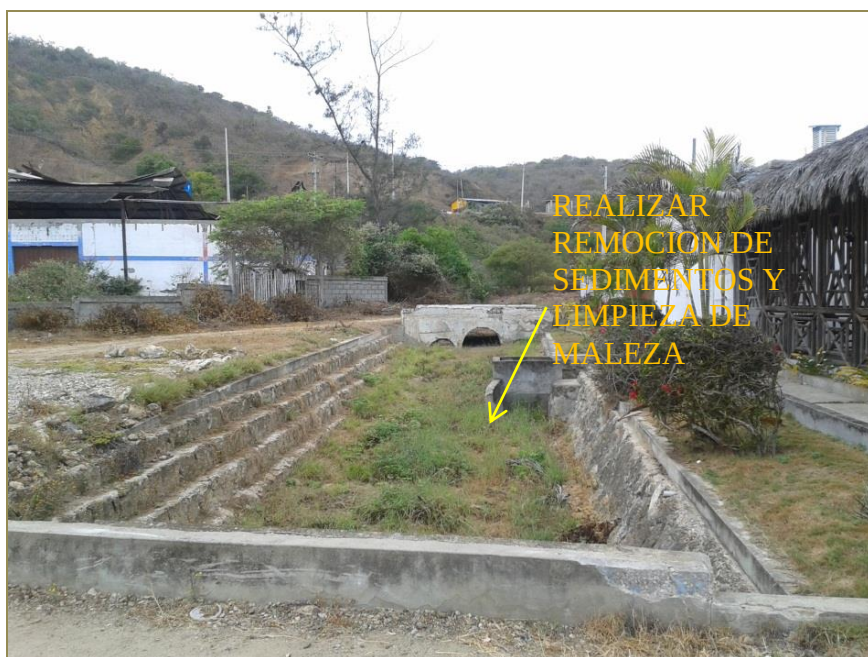
Fotografía 15: Estado actual de canal de aguas lluvias existentes.
