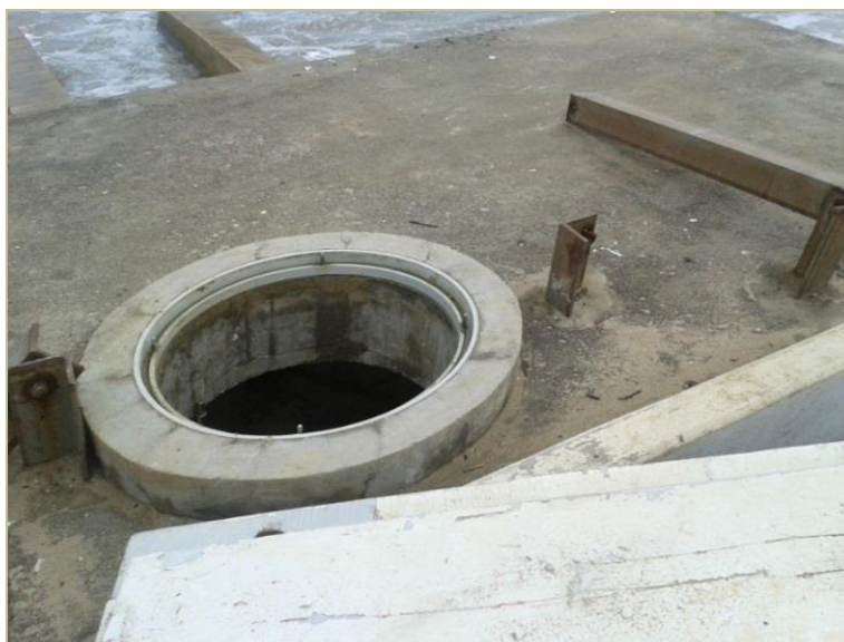
Fotografía 4.- Pozo de bombeo (registro circular)
